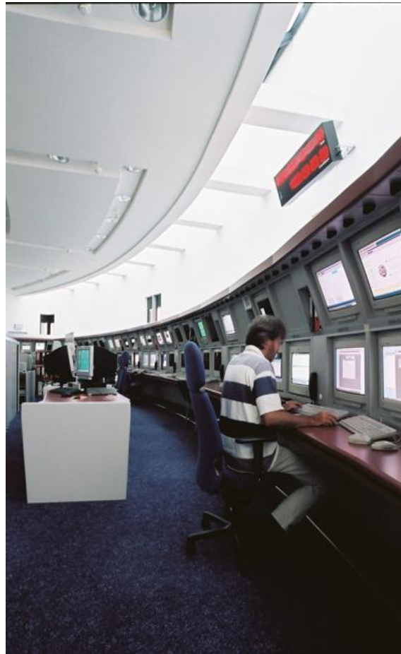
MSG Control Centre
